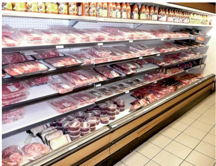
Kühlregal in Supermarkt
